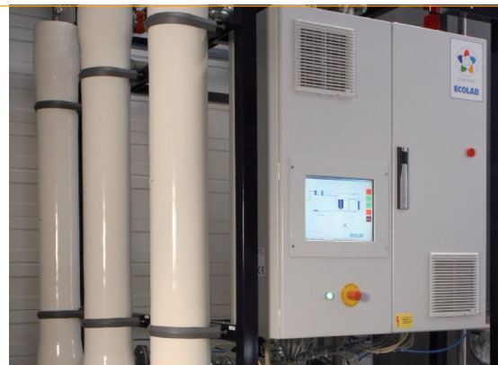
■ Herzstück der UF-Anlage: Die Membraneinheit mit Schaltschrank und Bedienmonitor.
